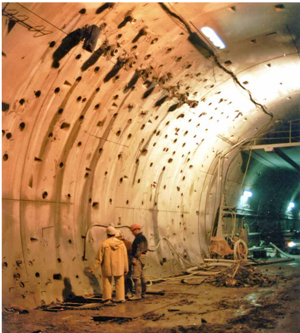
Fig. 9. Vista della parete allestita con prefiori e preventers.
