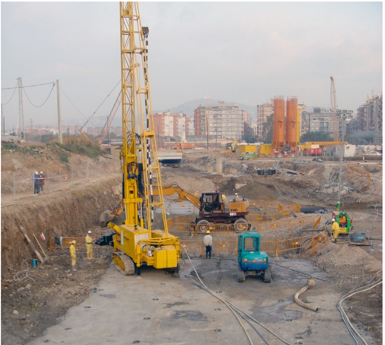
Fig. 32. Sonda idraulica PACCHIOSI P1500 modello ES con pennone di prolunga; intervento su piano di lavoro; in secondo piano i silos della centrale di stoccaggio materiali, dosaggio, miscelazione e pompaggio miscele cementizie.
