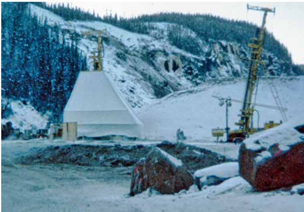
Fig. 7. Sonda P 1500 con copertura mobile contro il freddo.
