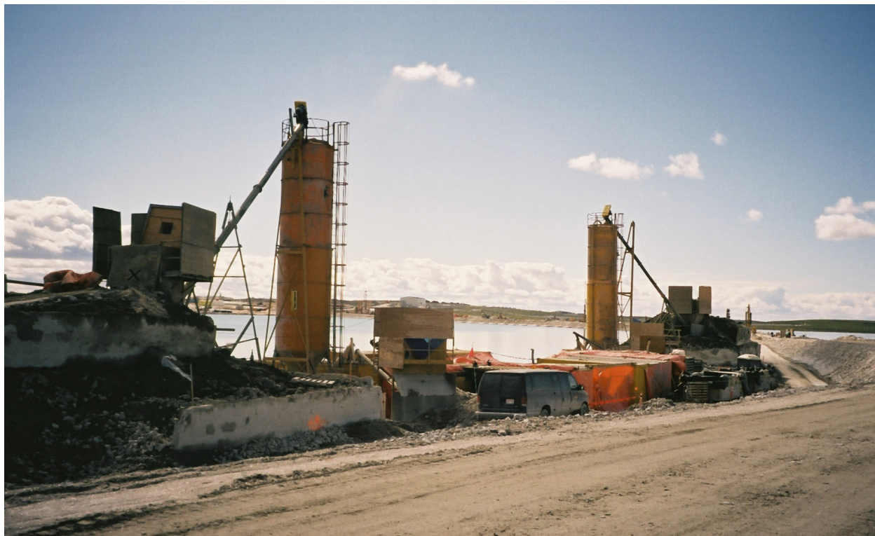
Fig. 9. Impianto di miscelazione Pacchiosi all'aperto.
