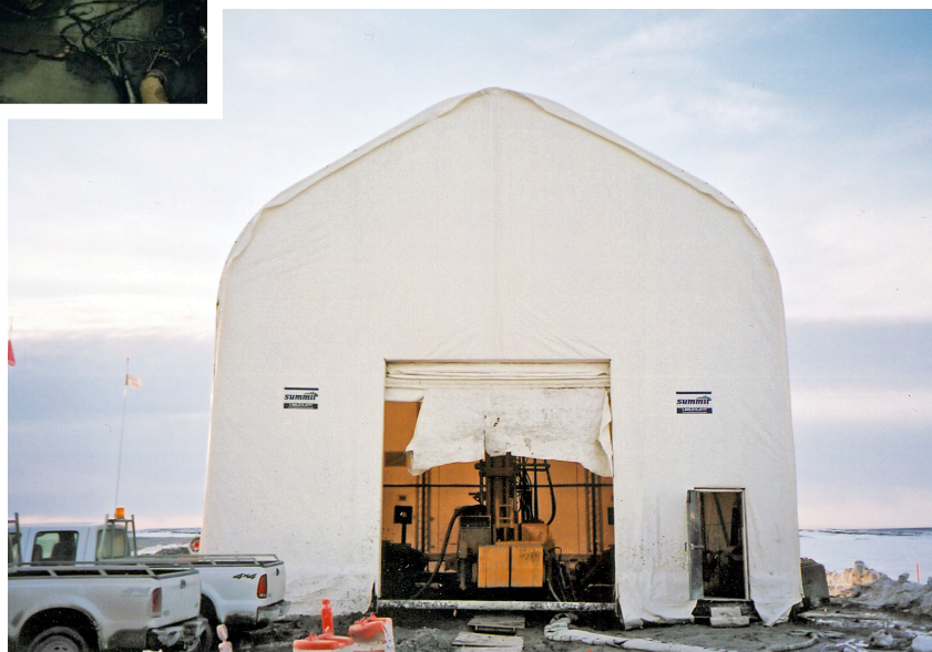
Fig. 6. Capannone mobile a protezione delle attrezzature e vista della macchina all'opera all'interno.
